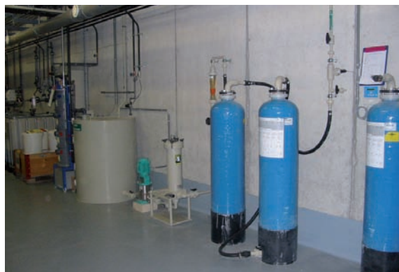
Ionenaustauscher-Kreislaufanlage für die fleckenfreie Trocknung.
