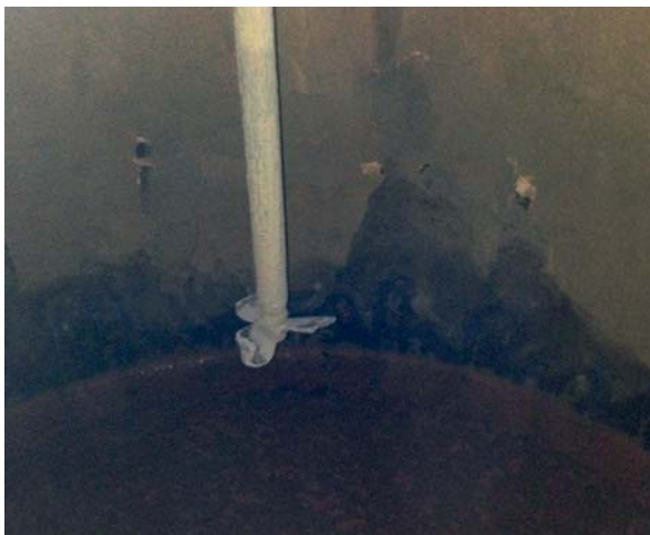
Weiteres Beispiel: defektes Rührorgan eines Rührwerks
