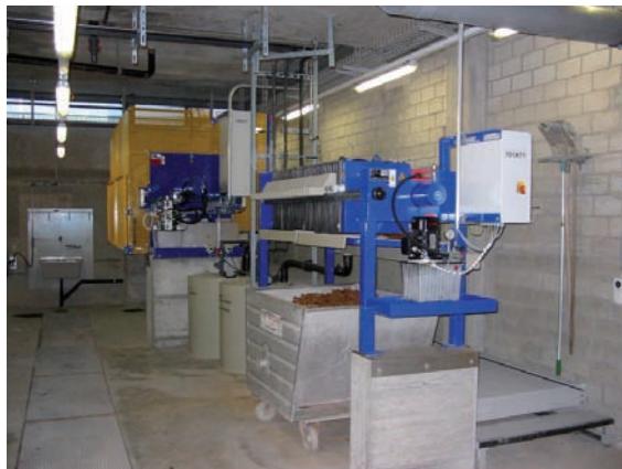
Schlammwässerung mittels Filterpressen
