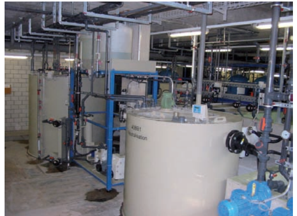
Neutralisation und Sonderbehandlung
