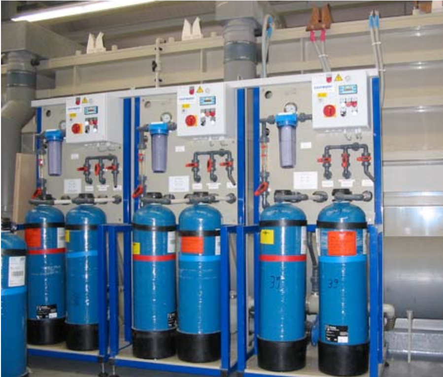
Bild 2: REH Anlagen zur Kreislaufführung von Spülwässern (abwasserfreier Betrieb)
